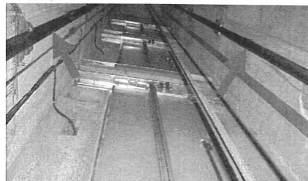
(6) 車廂導軌及其固定托架與接軌版 (須經重新校正調整確認)。
